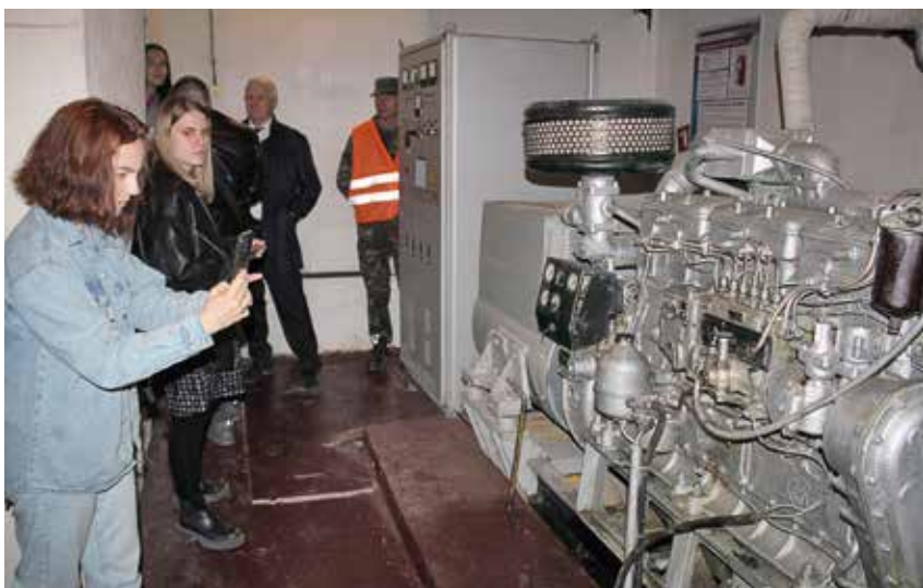
Защитное сооружение полностью автономно – дизельный генератор вырабатывает электричество
