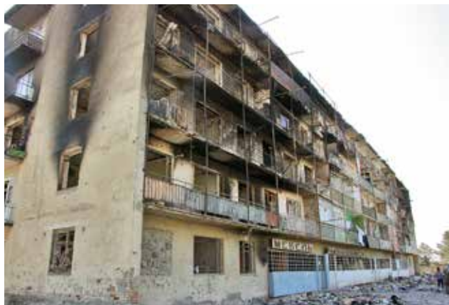
Разрушенные дома жителям временно пришлось сменить на палаточные лагеря
