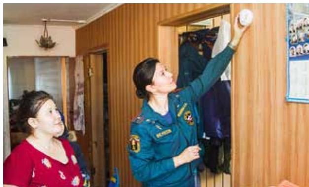
Установка автономного пожарного извещателя в домах многодетных семей
