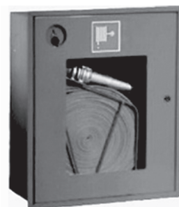
Пожарные краны и средства обеспечения их использования
